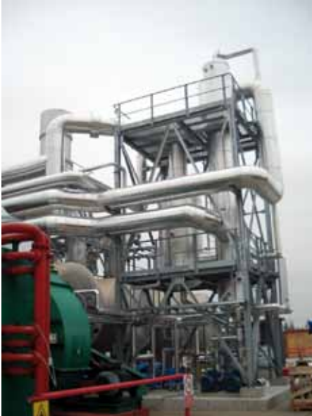
Sistema de recuperación de energía
