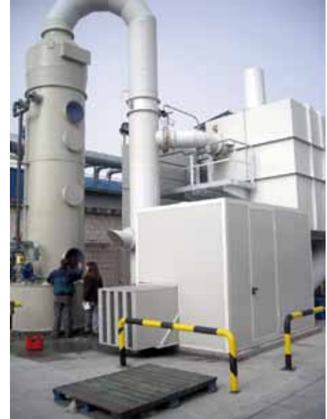
Lavado de gases y oxidación térmica regenerativa
