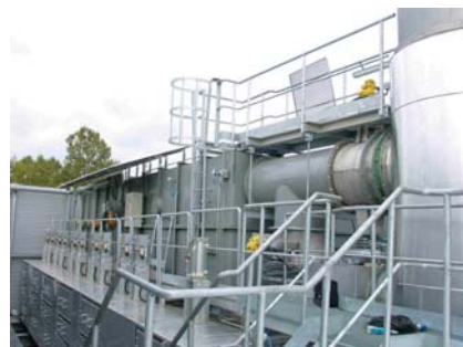
Instalación de recuperación de calor por calentamiento de fluido térmico
