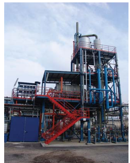
Instalación de recuperación de vapor
