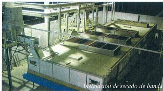
Instalación de secado de banda
