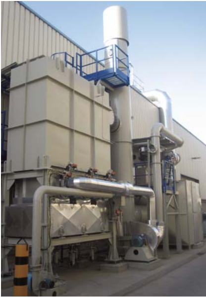
Instalación de reducción de COVs
