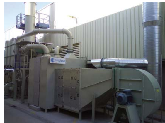
Filtro y roto-concentrador
