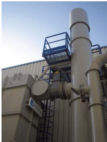
By-pass de la chimenea
