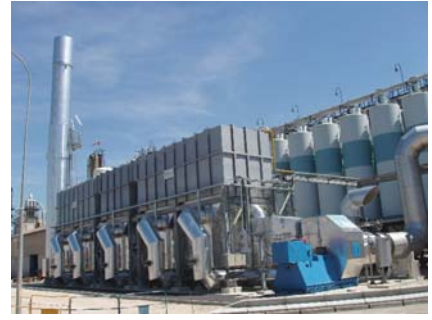
Oxidador térmico regenerativo de 5 torres
